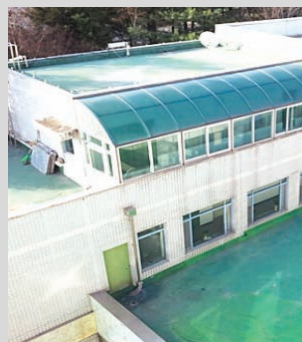
관리동 북쪽 보수 전
